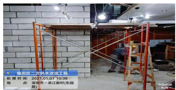
图 11 国企大厦作业脚手板未满铺，未绑扎牢固，无防护栏杆。
