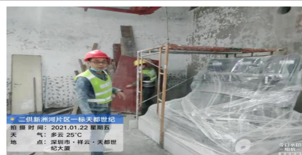
图 19 操作平台脚手板未满铺，且未有防护栏杆。
