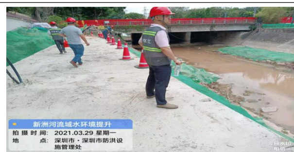
图 23 挑台临边安全防护措施缺失。
