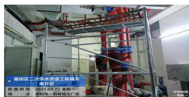
图 21 水池内作业现场操作平台上部无安全防护栏杆、无上下爬梯
