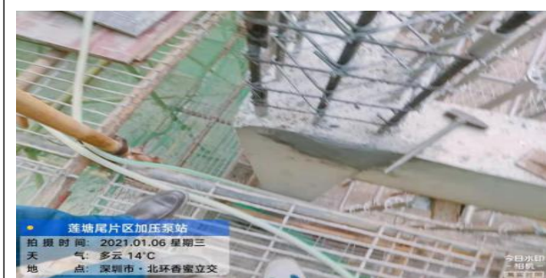
图 10 外脚手架与墙体之间缝隙未设置安全网。
