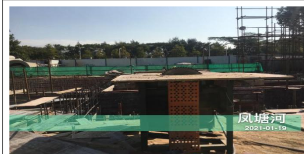
图 18 泵房支模木工用圆盘锯无防护罩，未配备消防设施。
