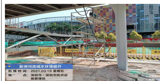
图 20 操作平台放置不稳固，缺少斜支撑杆，脚手板未满铺
