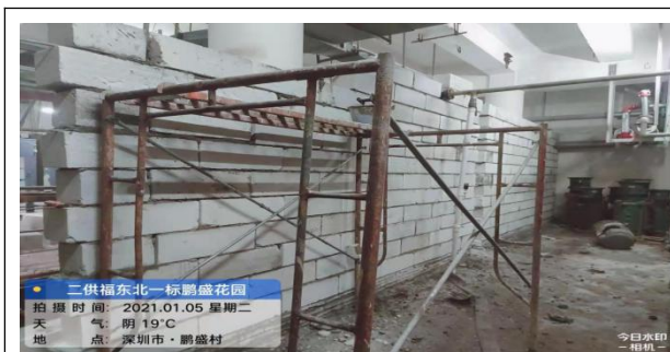
图 8 施工现场高架作业，脚手板未满铺，且无防护栏杆。
