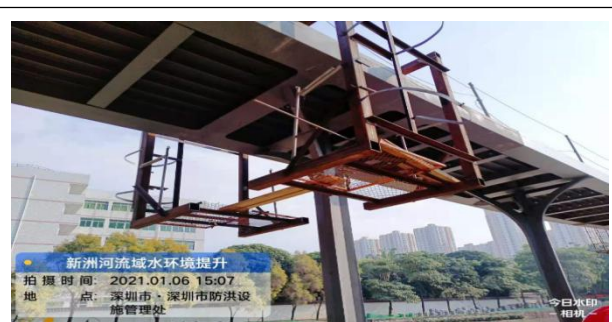
图 9 空中栈道操作平台无防护栏杆。
