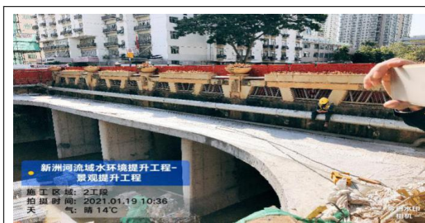
图 16 悬桥临边防护缺失，工人桥面临边作业人员未系挂安全绳
