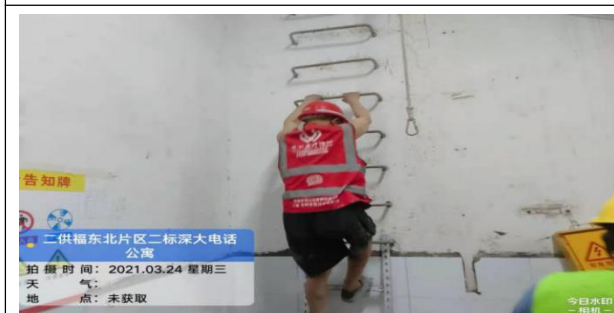
图 22 工人高处作业未配戴安全带。
