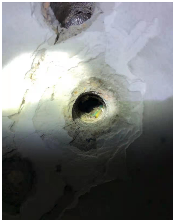
(图二) 地下车库的天花钻孔内显示伤及的预埋照明线路
