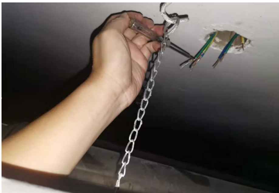
(图四) 地下车库照明灯用电线，有六根电源线线头铜芯裸露。
