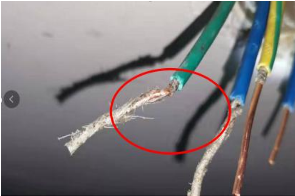
(图五) 现场绿色电源线头裸露呈现烧熔现象。
