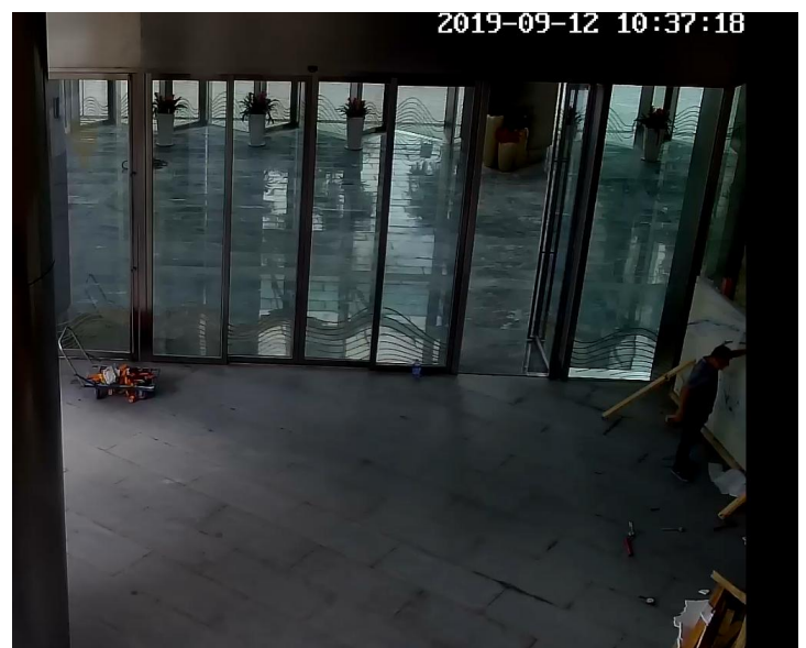
姜某作业中（未佩戴安全防护用品）
