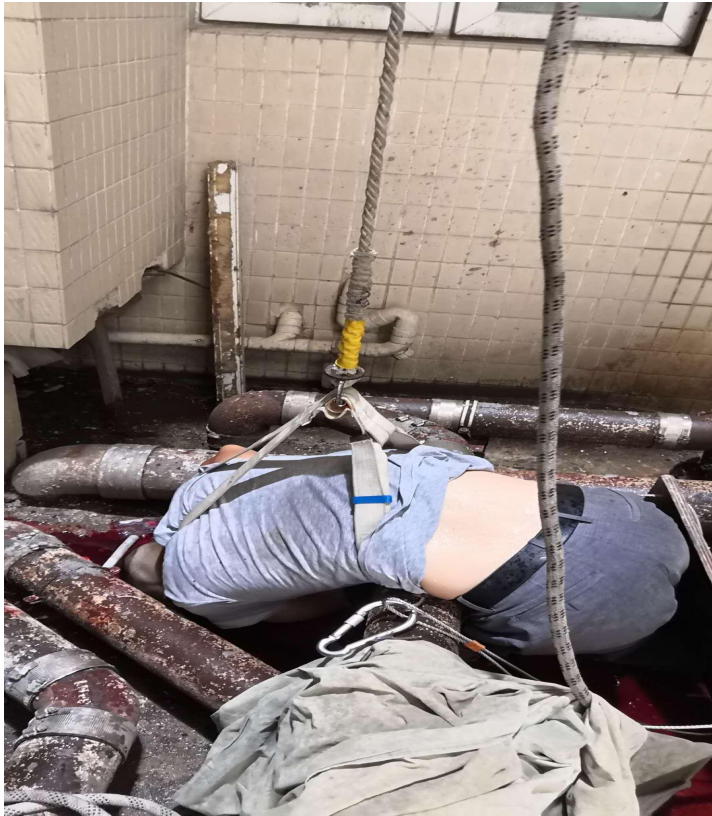
事故现场的坠落点（2楼天井平台）
