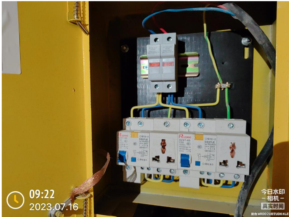
图 2 涉事商铺临时施工电箱
