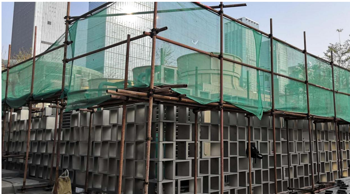
礼园不锈钢景墙部分状况
