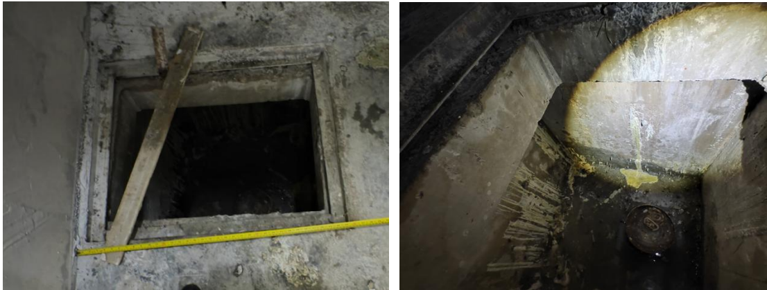
图4 事发现场集水井情况
