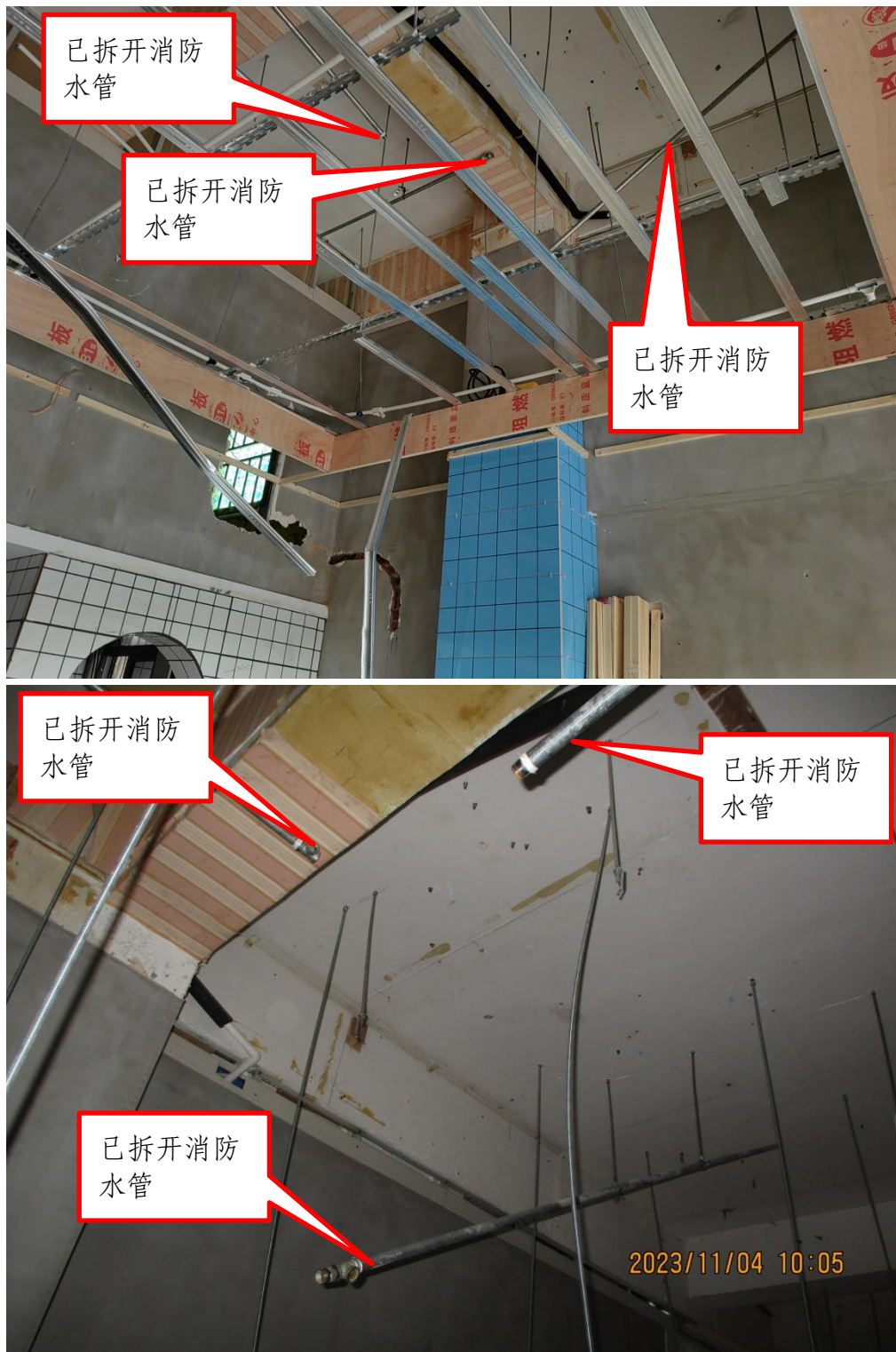
图 6 涉事正在装修店铺龙骨架上已有三段已拆开消防水管
