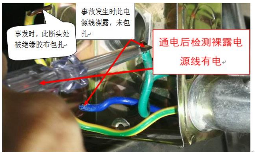
现场被剪电源线测电状况
