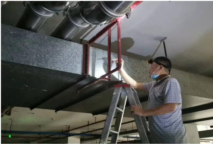
(图三) 现场检测，金属支架未发现带电现象。
