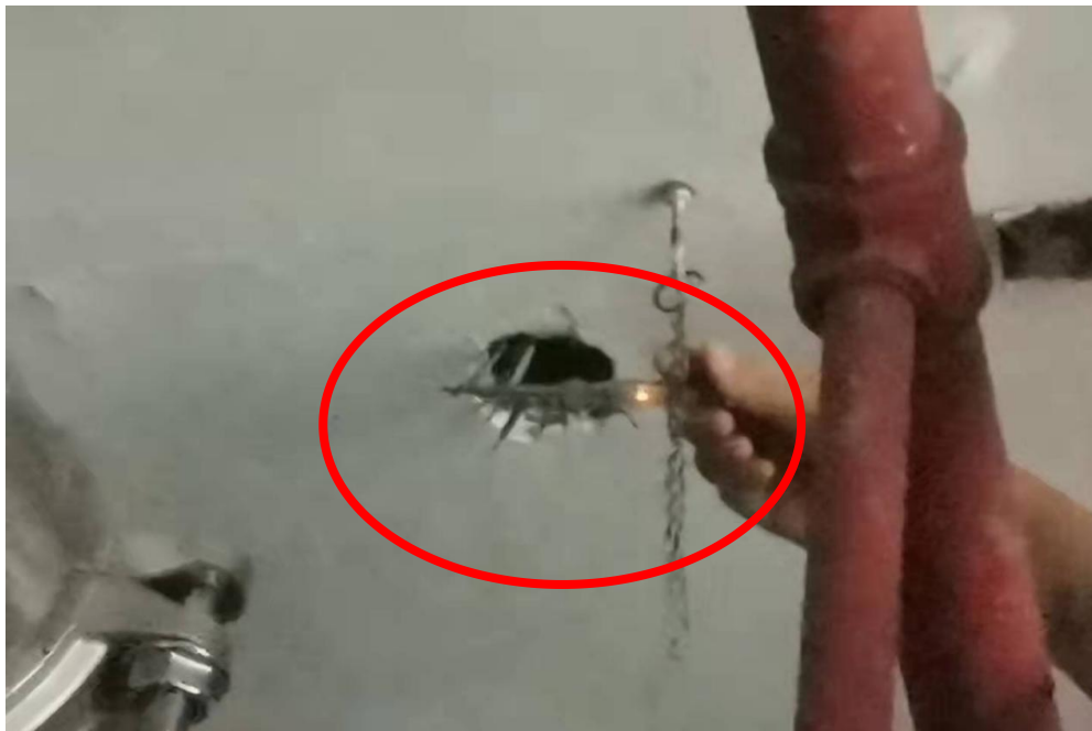
(图六) 现场测量绿色电源线存在带电现象。
