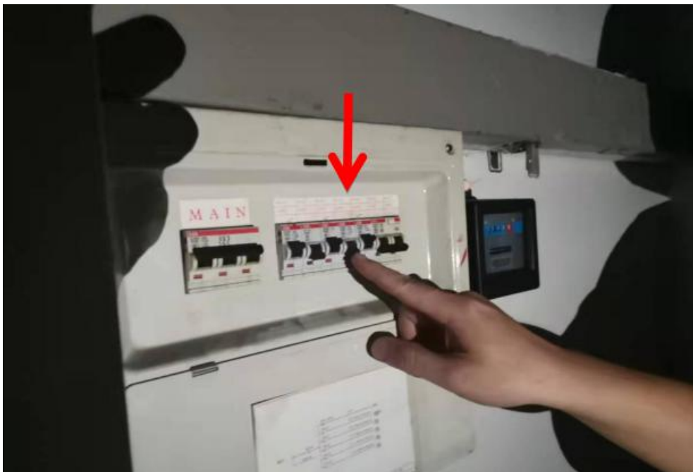
(图八) 经过现场勘查确认，事发现场绿色电源线与该组电源开关连接。
