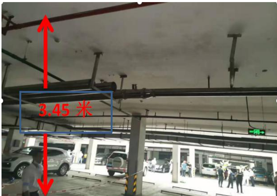
(图一) 地下车库事发现场，天花距地面高度为 3.45 米
