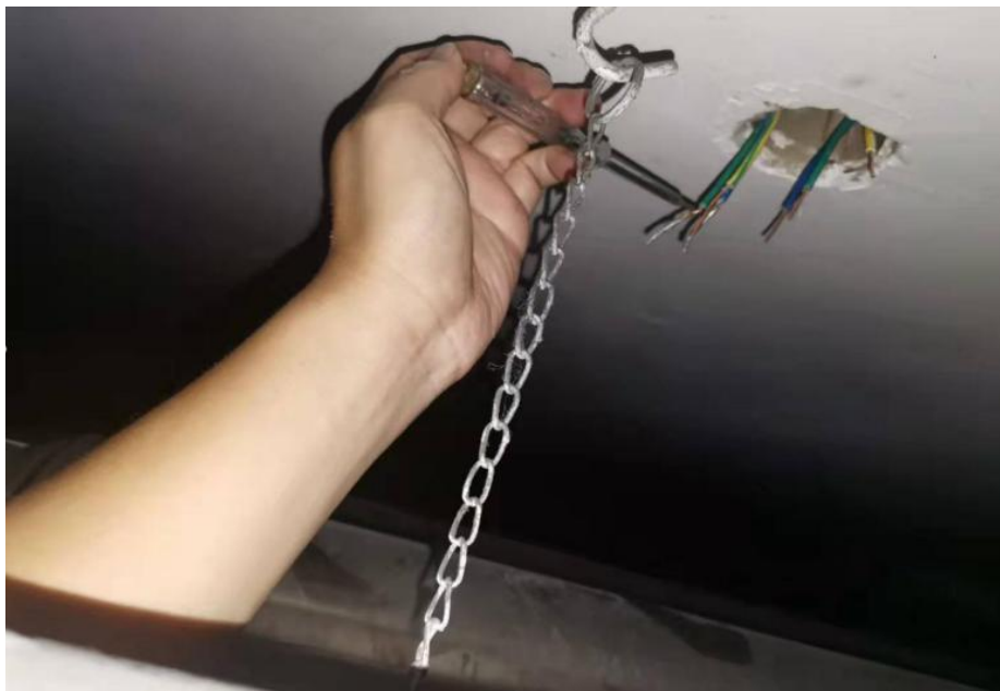
(图四) 地下车库照明灯用电线，有六根电源线线头铜芯裸露。
