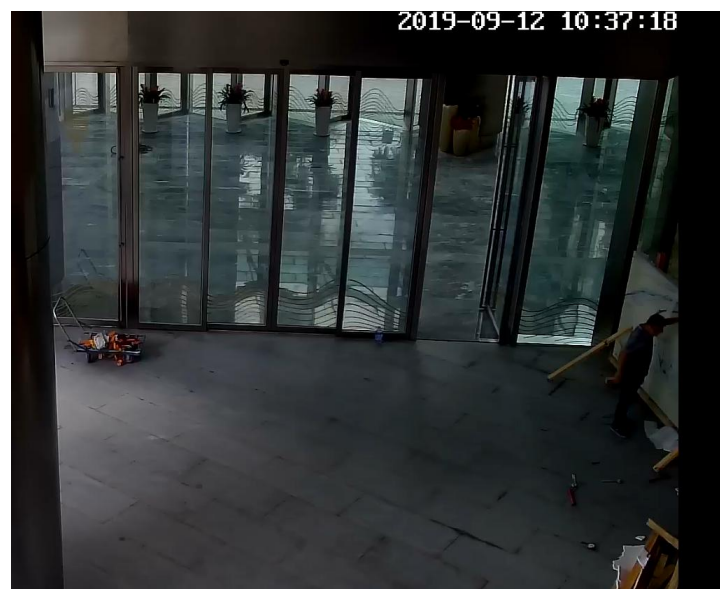
姜某作业中（未佩戴安全防护用品）
